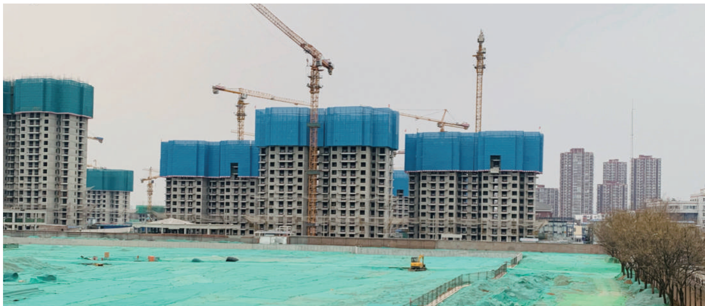
西四环与西五环之间多个项目在建,将为区域带来多元供应。 摄影 张鑫宇
