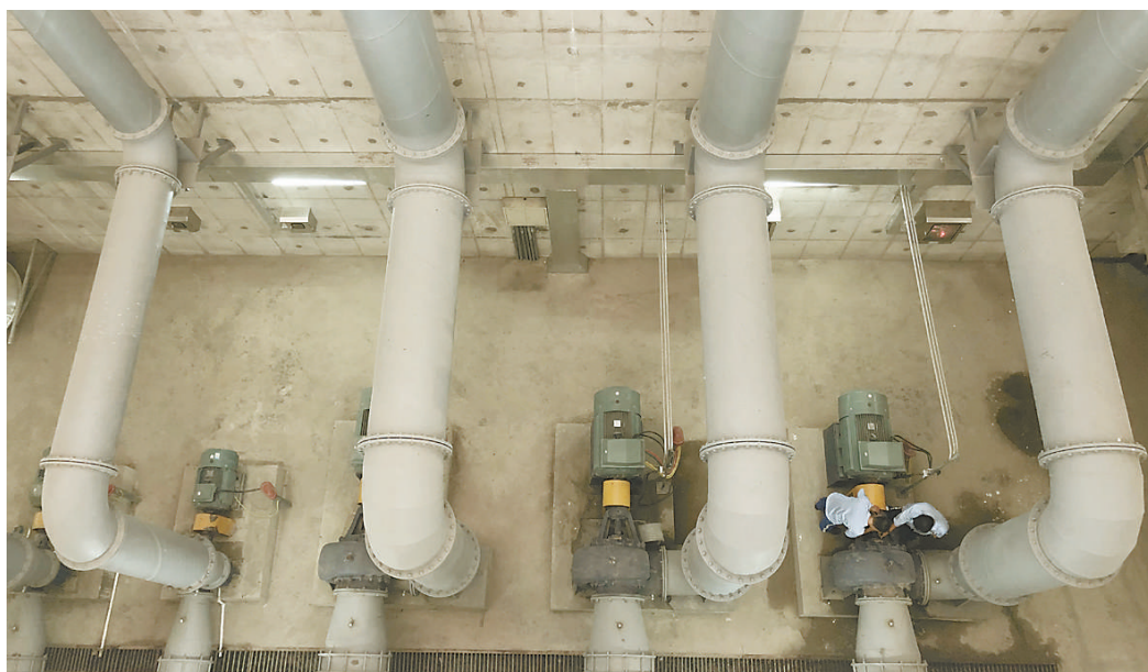
大红门桥区地下泵站,工作人员在检查水泵。
